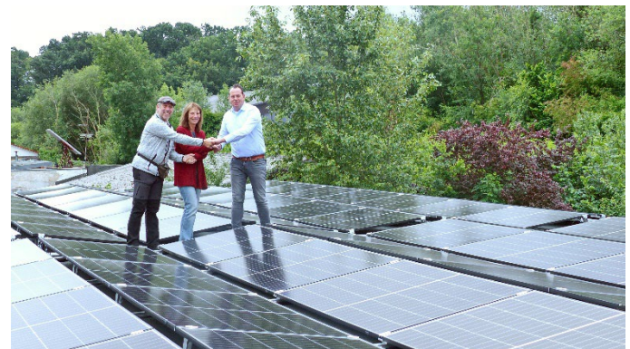
Bild 1: Fertig installierte PV-Anlage auf dem Kulturzentrum Krawatte
